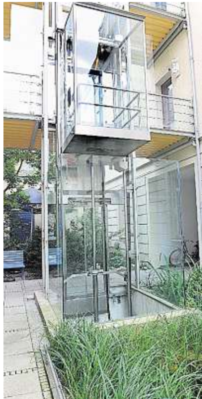
Der Lift Fidelgasse/Rote-Löwen-Straße ist ständig defekt. Foto: MZ-Archiv
